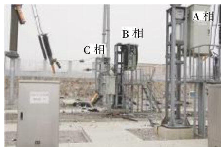
图3 5061断路器故障现场
